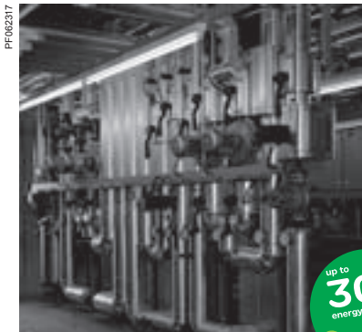
Comando di una stazione di pompaggio con ATV 12 (▲)
