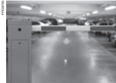
Comando barriera di accesso con ATV 12
